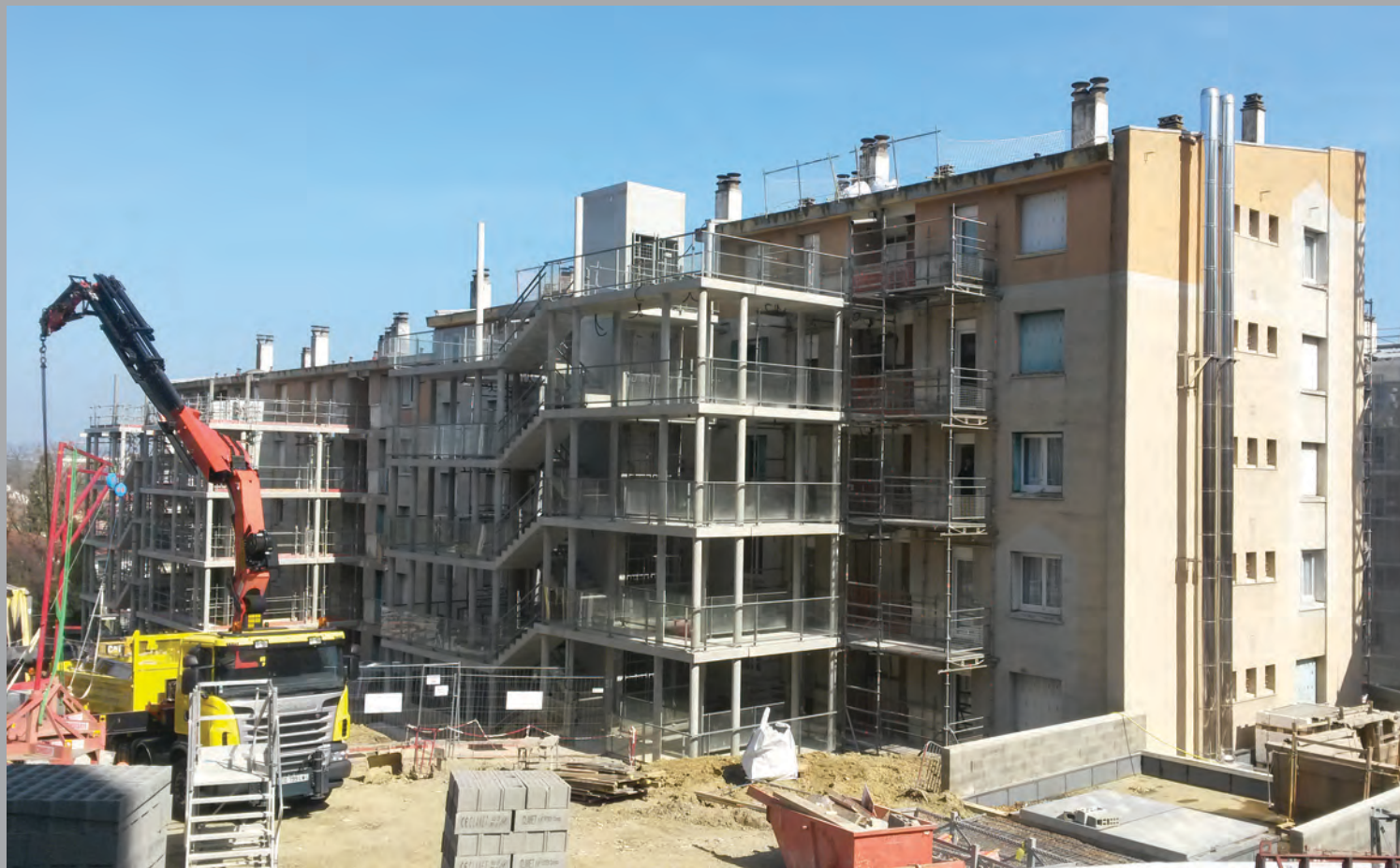
La chaufferie biomasse en pignon du bât. G (à droite)
