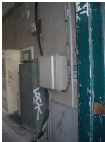
Une installation électrique non conforme révèle souvent des pratiques indignes.
