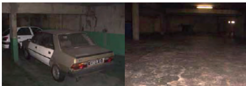
... voitures ventouses, sols et peintures dégradés.
