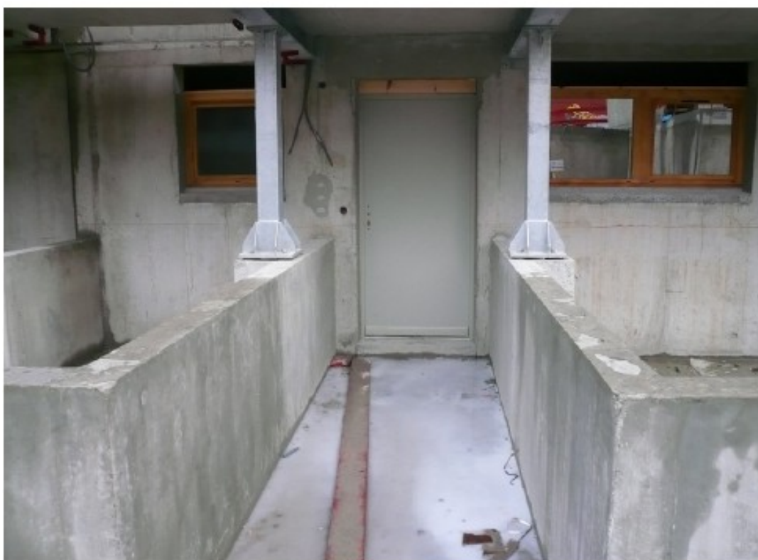
Bouygues-Immobilier- Immeubles B4-B6 : Non conformités Bacs-jardinières de 1 m de haut et platines de soutien
