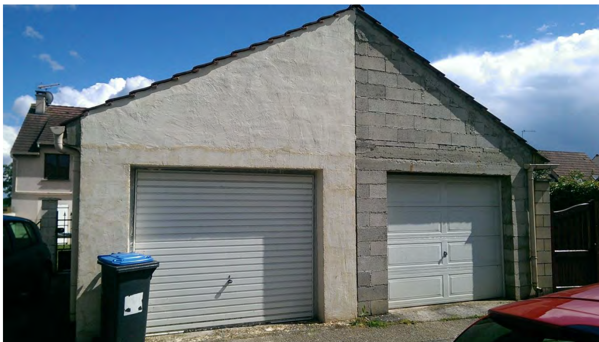
Opération « Les chaudrons » : exemple de finitions sur les arrières (enduit non réalisé)
