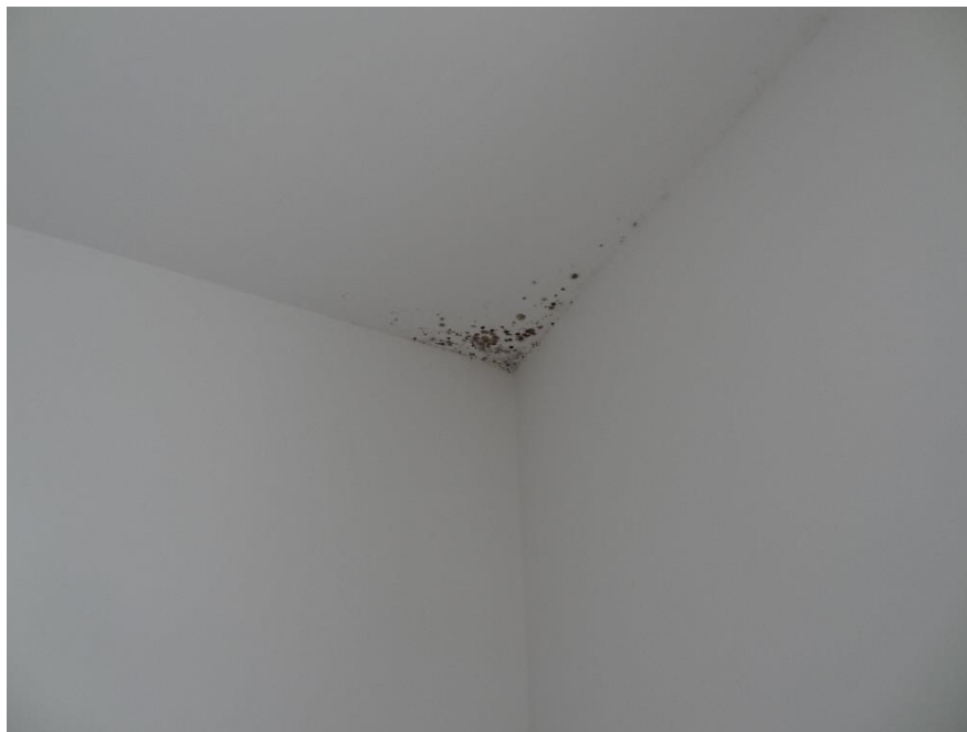
Traces d'humidités dans l'appartement n° 410
