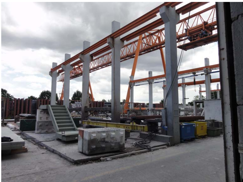
Zone d'entreposage, fin de séchage
